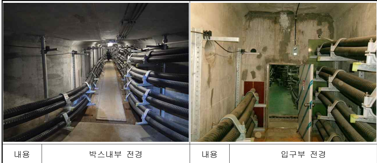
【사진 3.1】 문발SS인출 전력구 현황
